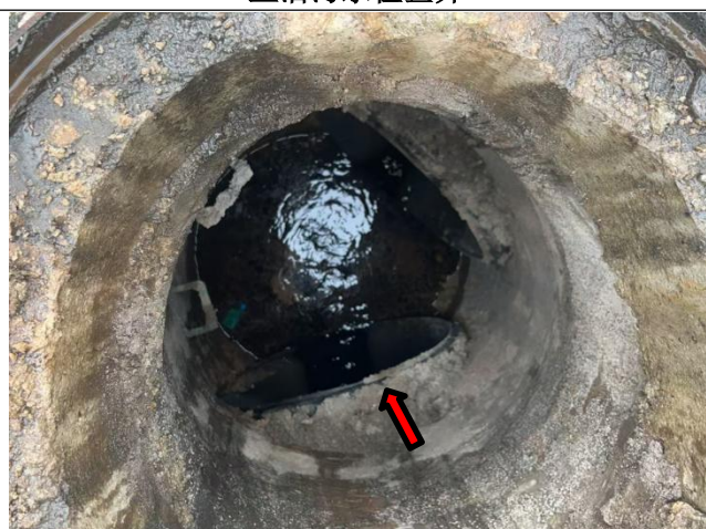
市政雨水管网检查井—雨水总排放口
