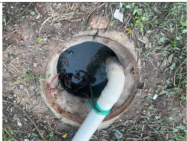
生活污水集污井—通过水泵定期外排至市政管网
