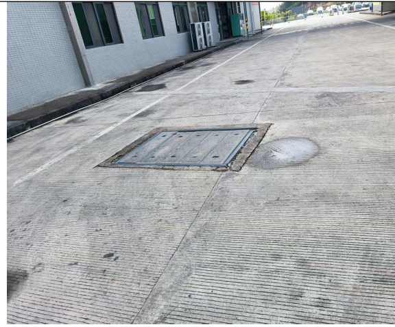
生活污水处理设施—化粪池
