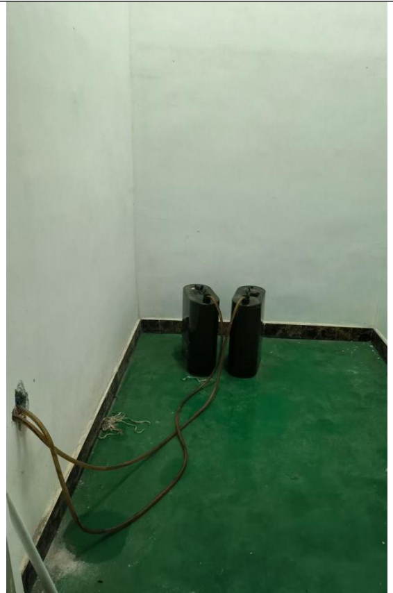
应急用柴油储存在发电机房储油间内
