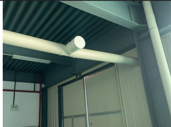
胶带房溶胶废气接入口已封堵
