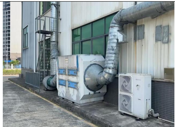
废气处理设施涂布废气接入口已封堵
