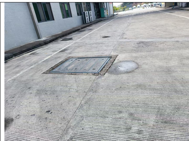
生活污水处理设施—化粪池
