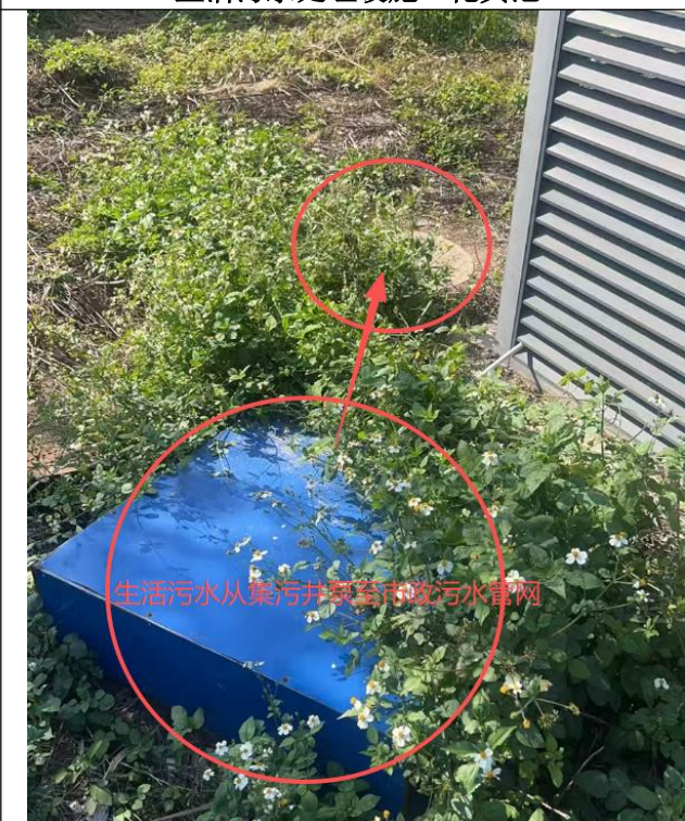
厂区生活污水未直接连通市政管网
