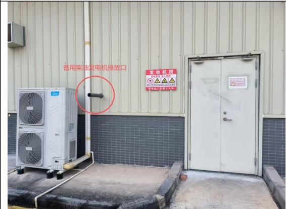
柴油发电机废气排放口
