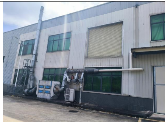
有机废气处理设施
