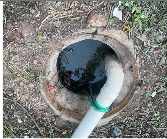
生活污水集污井—通过水泵定期外排至市政管网
