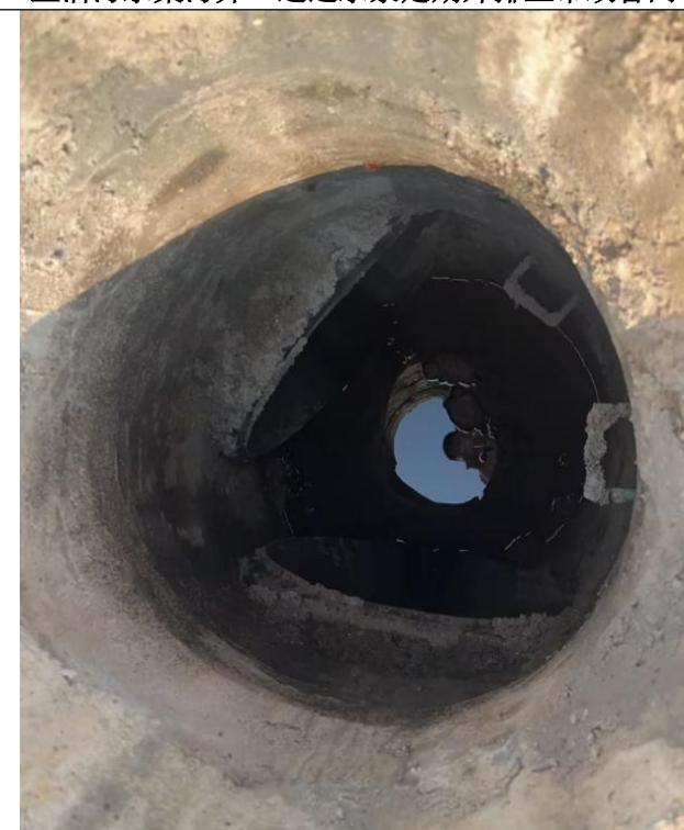
生活污水检查井
