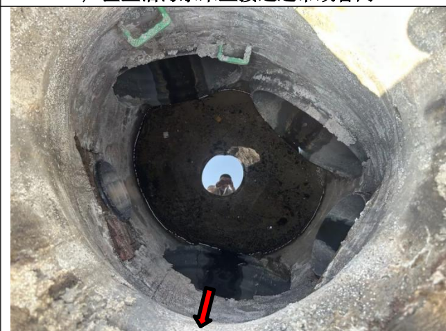
厂区内雨水检查井—汇流总口
