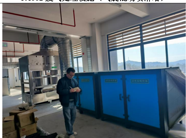
TA002 废气处理设施
