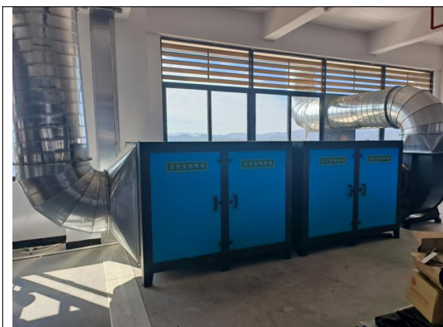
TA002 废气处理设施（活性炭吸附柜）
