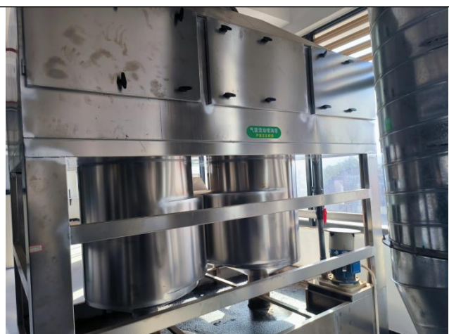
TA002 废气处理设施（气旋混动喷淋塔）
